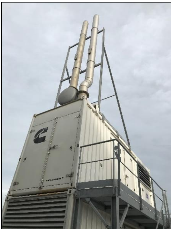
Groupe électrogène de secours (Punitaire < 3 MW)
