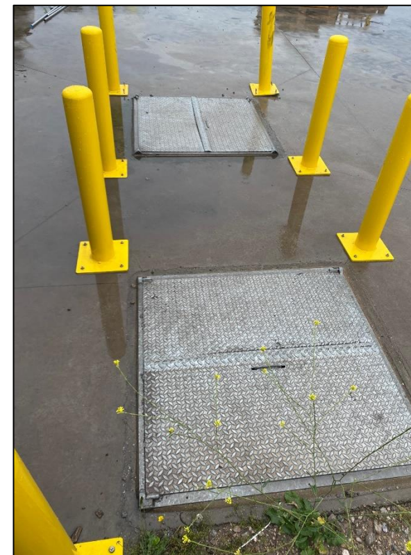
Cuves enterrées de stockage fuel
