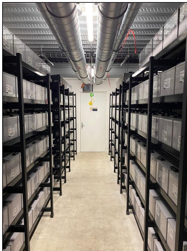
Salle de charge batteries
