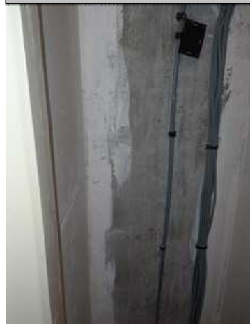
GAINE TECHNIQUE DU 1ER ETAGE
