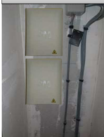
GAINE TECHNIQUE DU 2EME ETAGE
