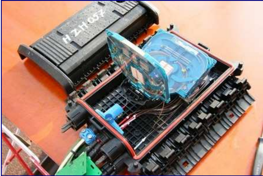
Le boîtier de raccordement, où chaque tronc GPON est subdivisé en 8 fibres
