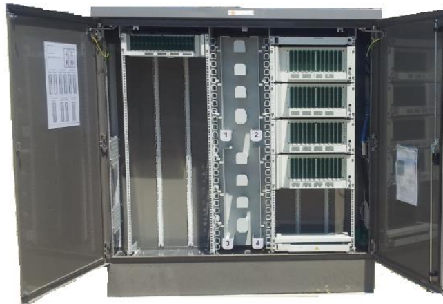
Exemple d'un PM, 360 locaux desservis, 576 fibres distribuées
