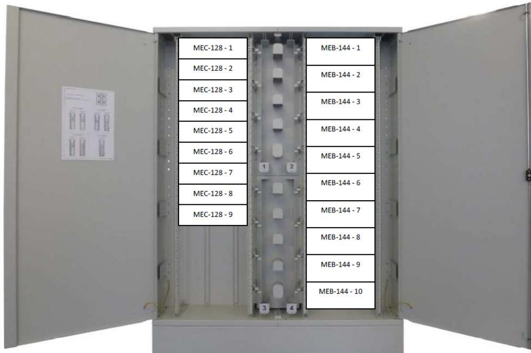
Armoire « Indoor » 2 x 40U (Exemple de tiroirs de distribution en 4U)
