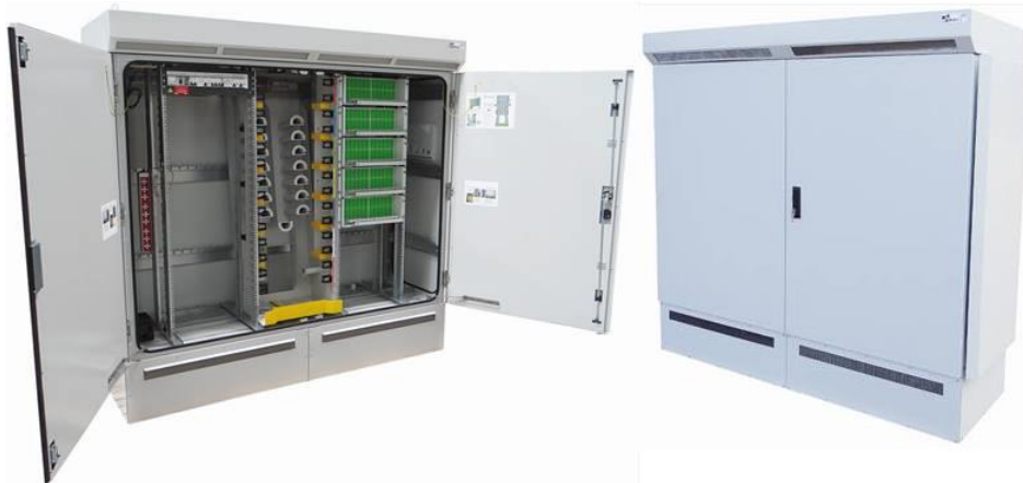
Armoires actives avec panneaux d'ombrage
