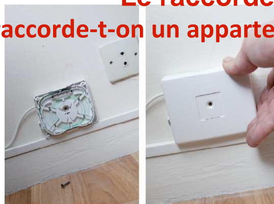
Prise optique à l'intérieur du logement.
