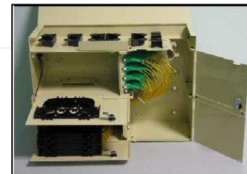
Boîtier en Pied d'immeuble : Point de Mutualisation
